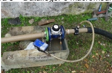
Figura 9 – Datalogger e macromedidor de vazão
