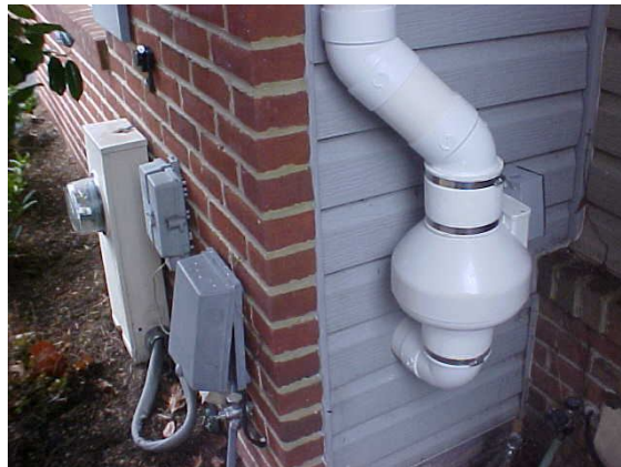
Foto 4 - Exaustor. Parte externa
